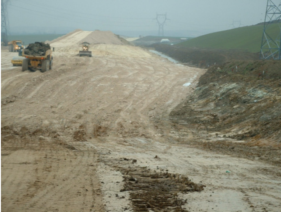
Fig. 1. Les Monts Gardés durant le chantier de la LGV : une topographie et un sol entièrement remodelés.
